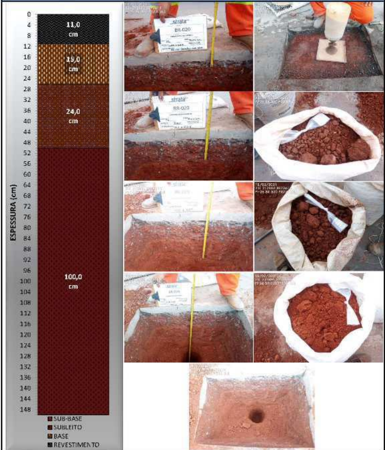
Figura 30: Relatório Fotográfico – PI-26 (Pista Sul)
