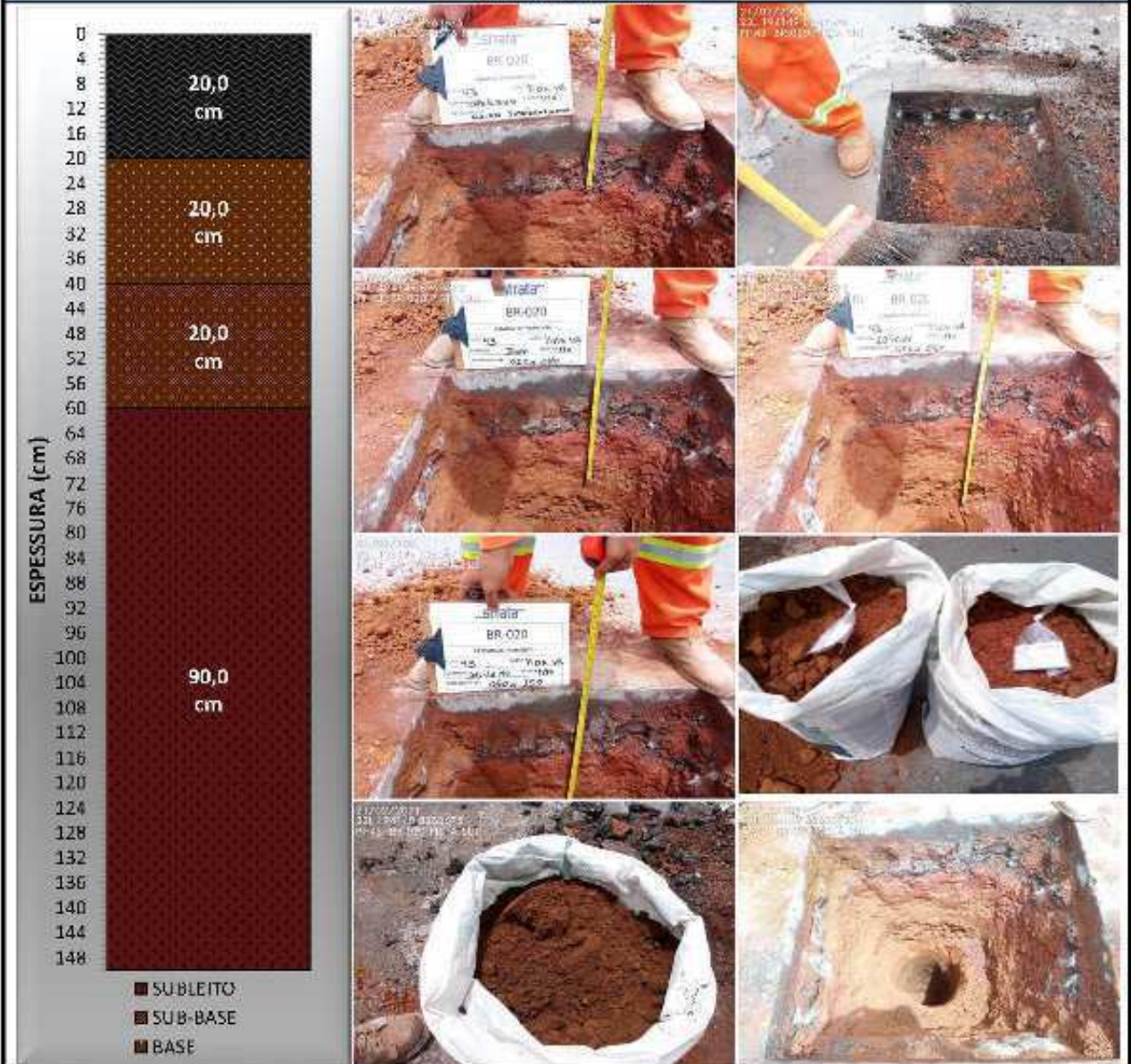
Figura 47: Relatório Fotográfico – PI-43 (Pista Sul)
