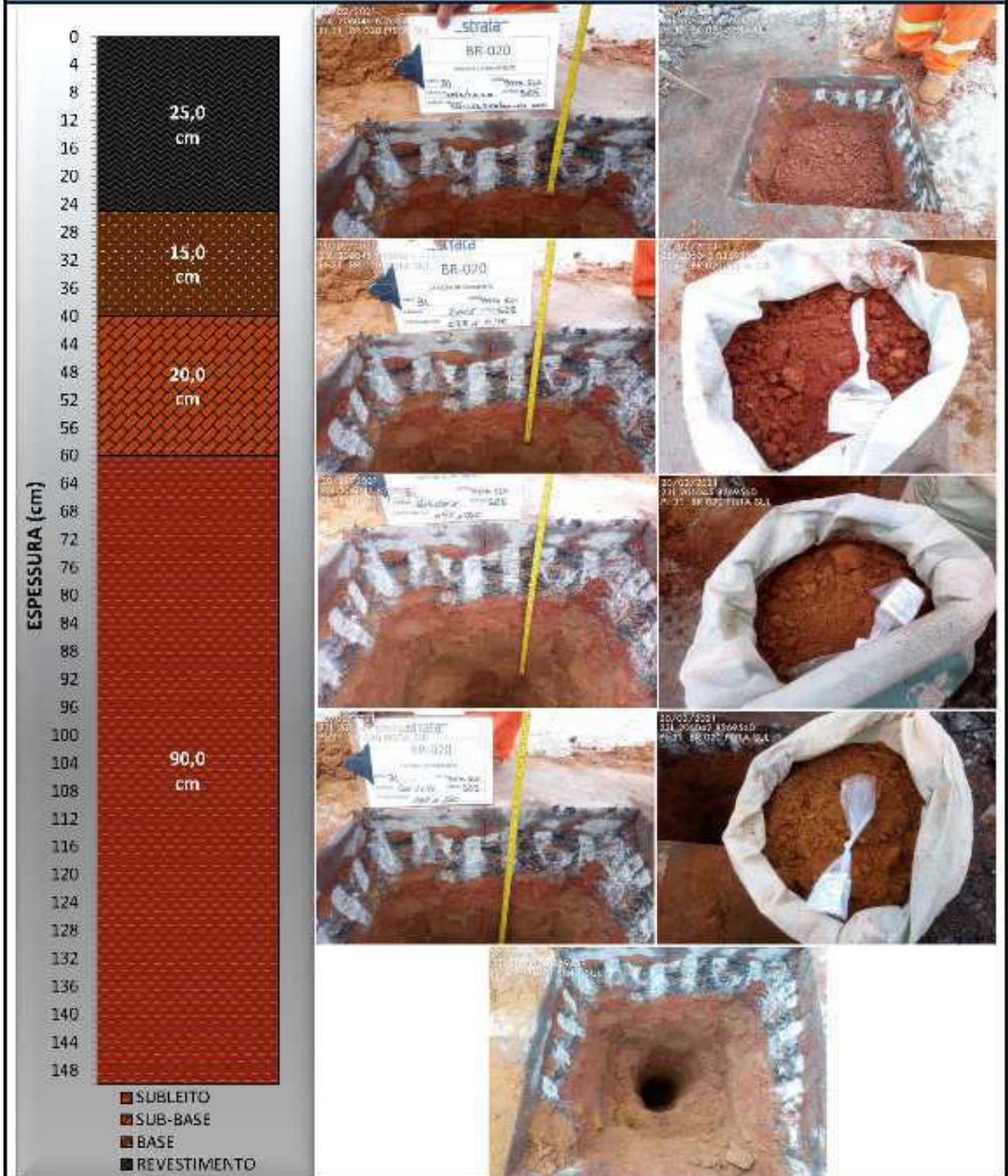
Figura 35: Relatório Fotográfico – PI-31 (Pista Sul)
