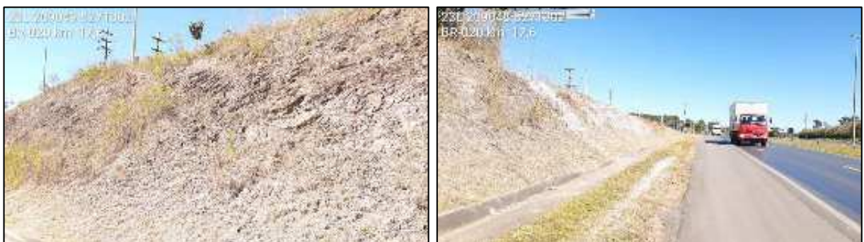
Figura 63 e 64: Material de 2ª Categoria no km 17,6
