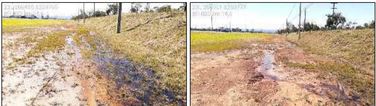
Figura 67 e 68: Região com presença de Solo Saturado
