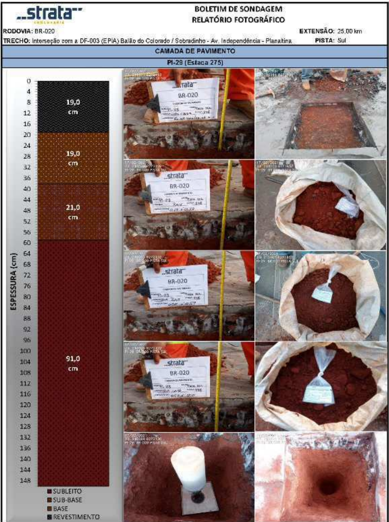
Figura 33: Relatório Fotográfico – PI-29 (Pista Sul)
