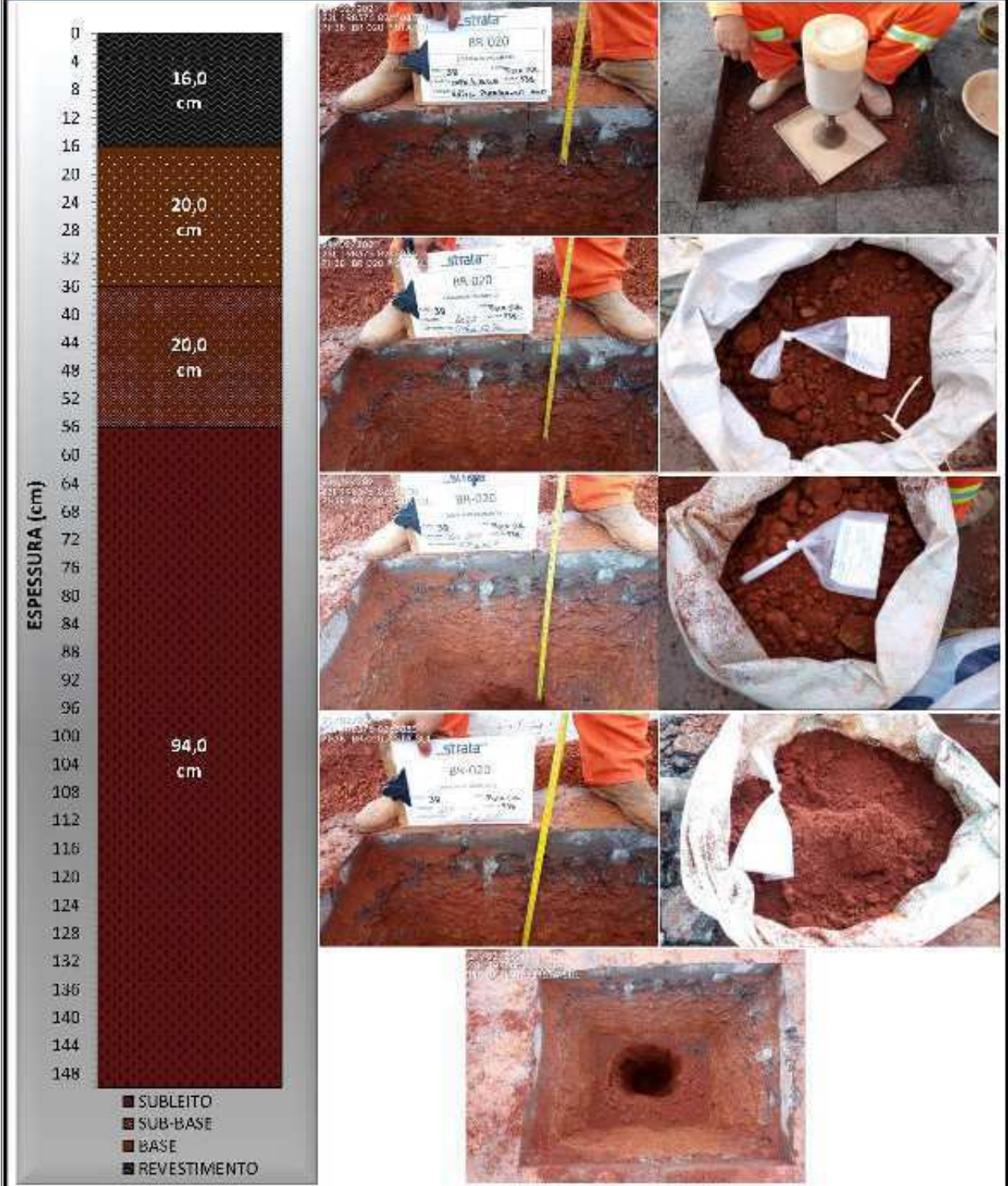
Figura 42: Relatório Fotográfico – PI-38 (Pista Sul)
