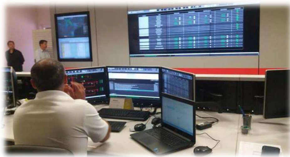
Figura 14: Exemplo de um Centro de Controle Operacional
