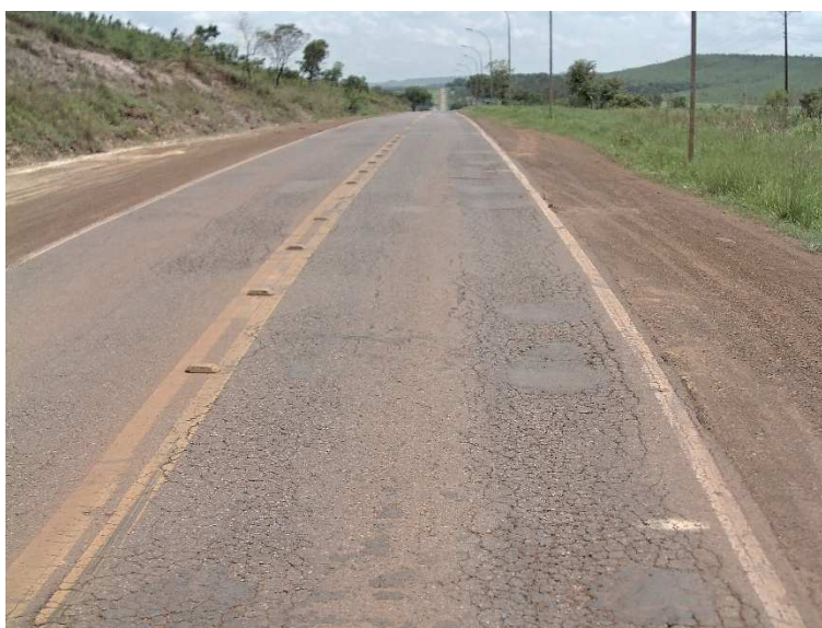
Figura 95 – km 27,582 (LD) – Acostamento sem revestimento
