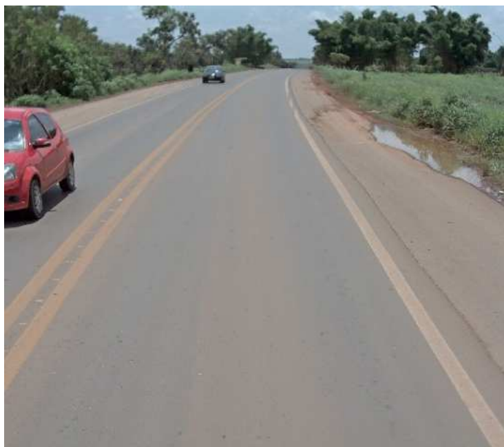
Figura 93 – km 11,405 (LD) – Acostamento a sofrer reparos localizados
