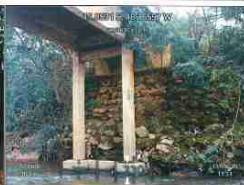
Fig. 02 - Vista da RC 02, nota-se a contenção em pedras, o solapamento da contenção, os blocos desenterrados e a estrutura exposta no pilar e arada, mesmo presença erosivo no lado do RC;
