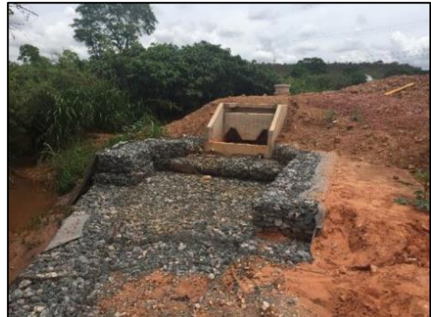
Foto 4: Extravasador da bacia de drenagem com lançamento final no córrego do Açude.
