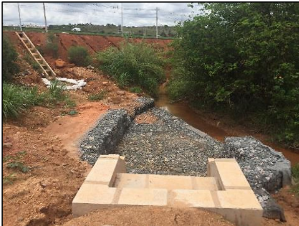
Foto 3: Extravasador da bacia de drenagem com lançamento final no córrego do Açude.
