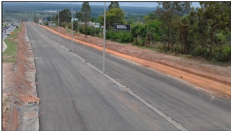
Foto 12: Mesmo trecho já com a capa asfáltica e sistema de drenagem pluvial em 2018.
