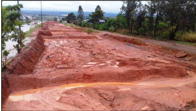
Foto 11: Processos erosivos que existiam em 2016.
