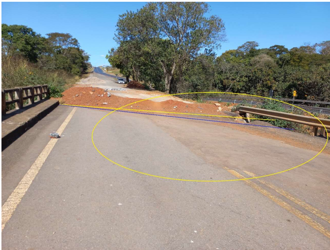
Fotografia n.º 27 – evidenciando deformação/torção do tabuleiro (26/07/2023)
