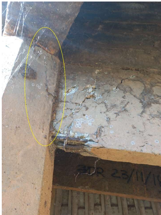
Fotografia n.º 59 – evidenciando plastificação, rachaduras na travessa e efeito de cunha no pilar (26/07/2023)
