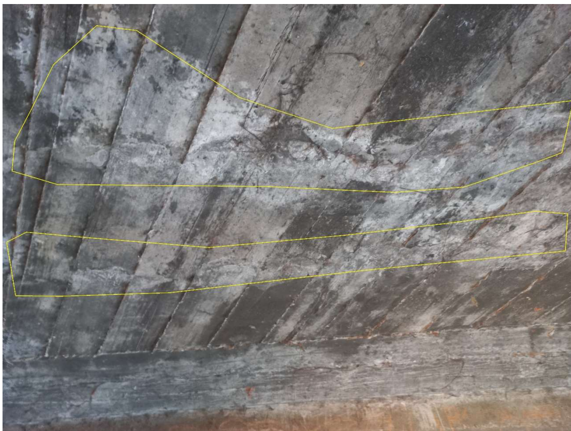
Fotografia n.º 44 – evidenciando infiltração em trincas e fissuras (26/07/2023)
