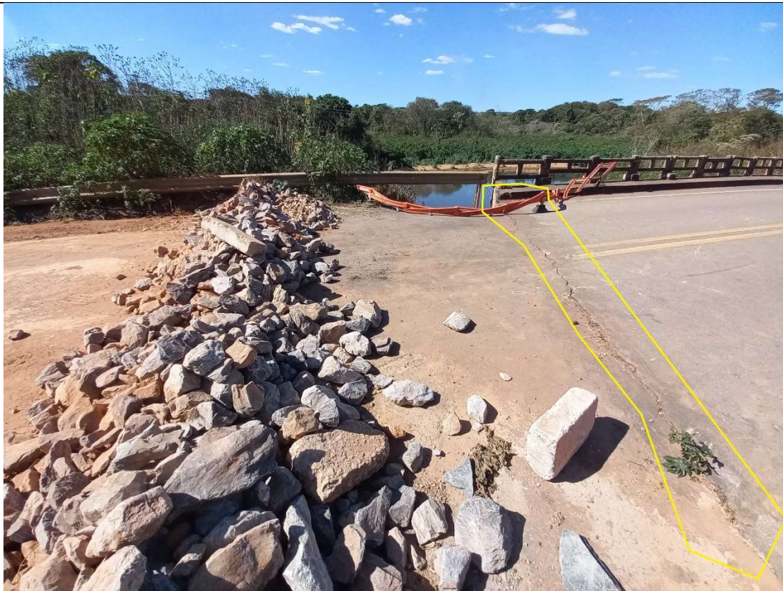
Fotografia n.º 45 – evidenciando Inexistência de junta de dilatação/movimentação (26/07/2023)
