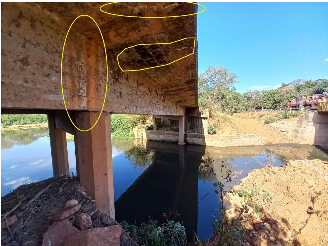
Fotografia n.º 42 – evidenciando deficiência na drenagem com a falta de buzinotes(26/07/2023)
