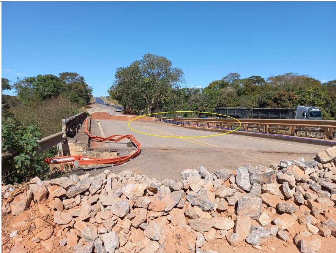
Fotografia n.º 25 – evidenciando deformação/torção do tabuleiro (26/07/2023)
