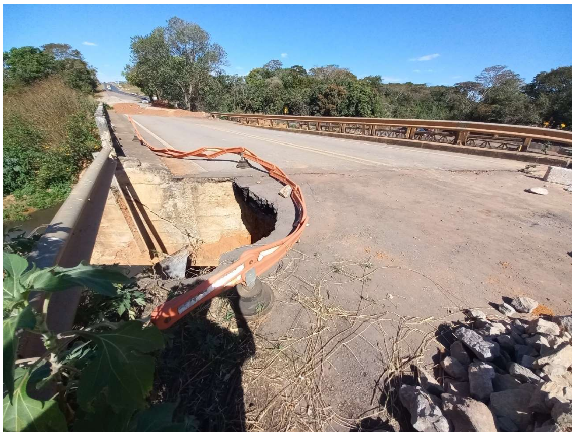
Fotografia n.º 54 – evidenciando erosão junto ao encontro/encabeçamento (26/07/2023)
