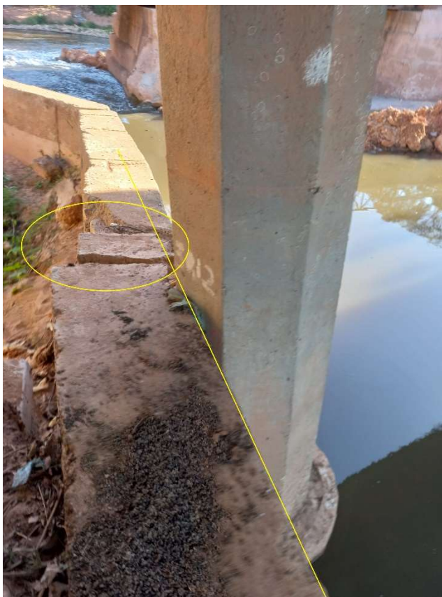
Fotografia n.º 81 – evidenciando rompimento do muro de concreto (26/07/2023)
