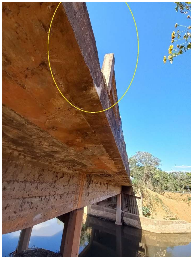
Fotografia n.º 47 – evidenciando inexistência de guarda-corpo (26/07/2023)
