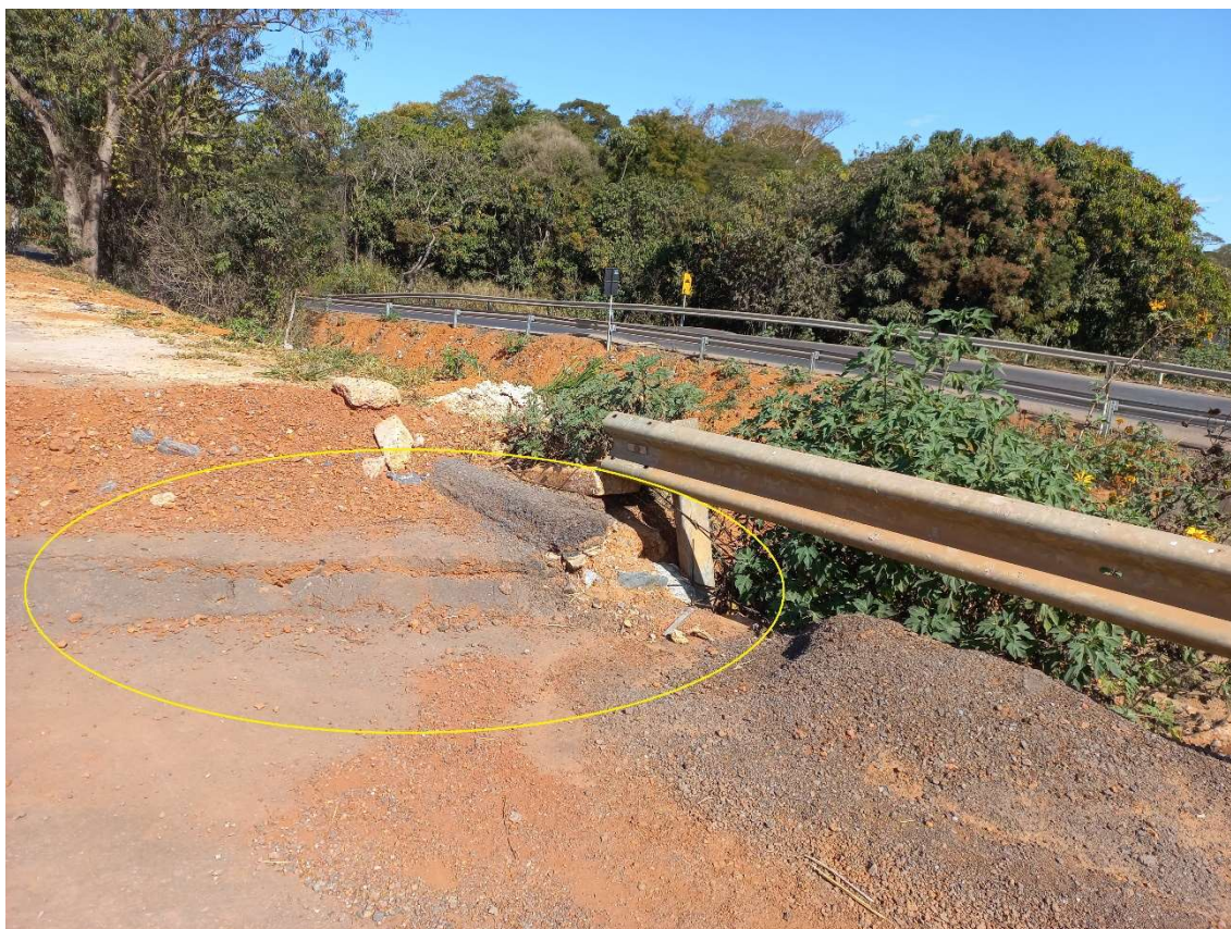
Fotografia n.º 28 – evidenciando deformação/torção do tabuleiro (26/07/2023)
