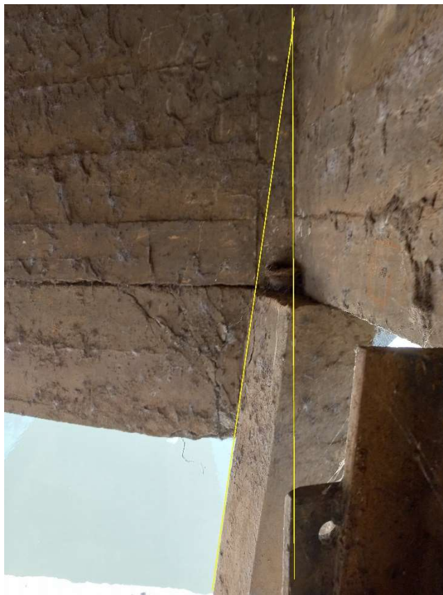
Fotografia n.º 65 – evidenciando desaparecimento do pórtico/pilar (26/07/2023)
