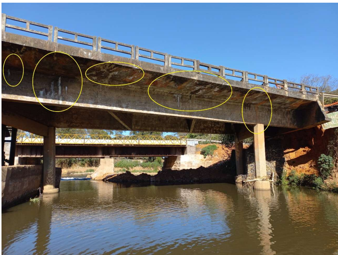
Fotografia n.º 38 – evidenciando deficiência na drenagem com a falta de buzinotes(26/07/2023)
