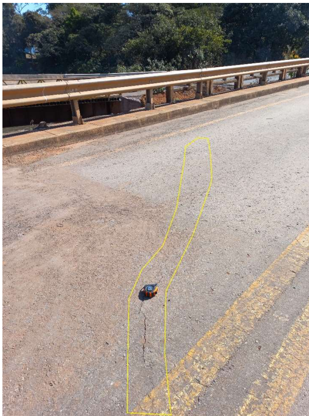
Fotografia n.º 33 – evidenciando fissuras e trincas no tabuleiro (26/07/2023)
