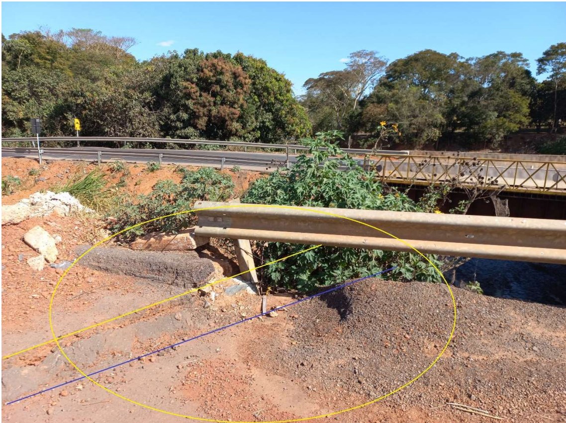
Fotografia n.º 30 – evidenciando deformação/torção do tabuleiro (26/07/2023)
