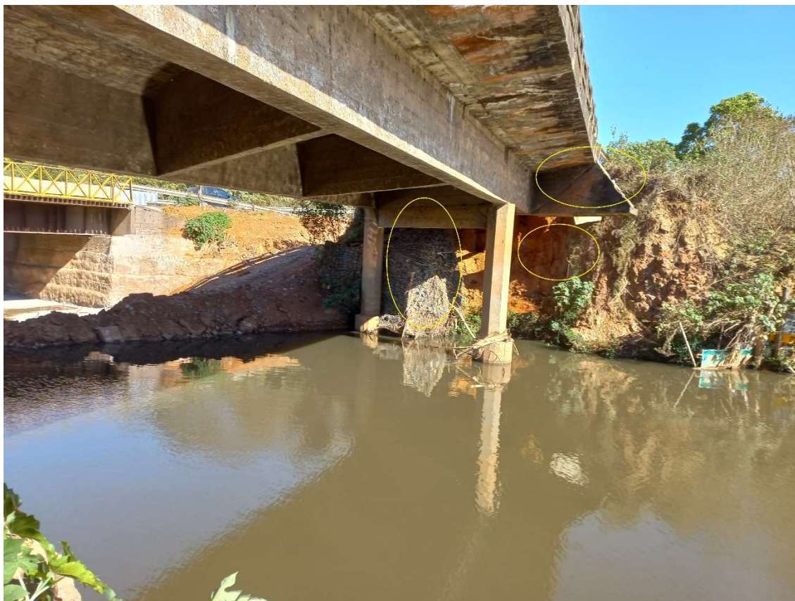
Fotografia n.º 73 – evidenciando ala rompida, colapso do muro de gabião e erosão junto ao encontro (26/07/2023)
