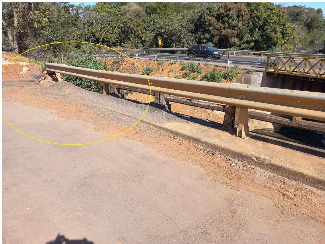
Fotografia n.º 34 – evidenciando deformação/torção do tabuleiro (26/07/2023)
