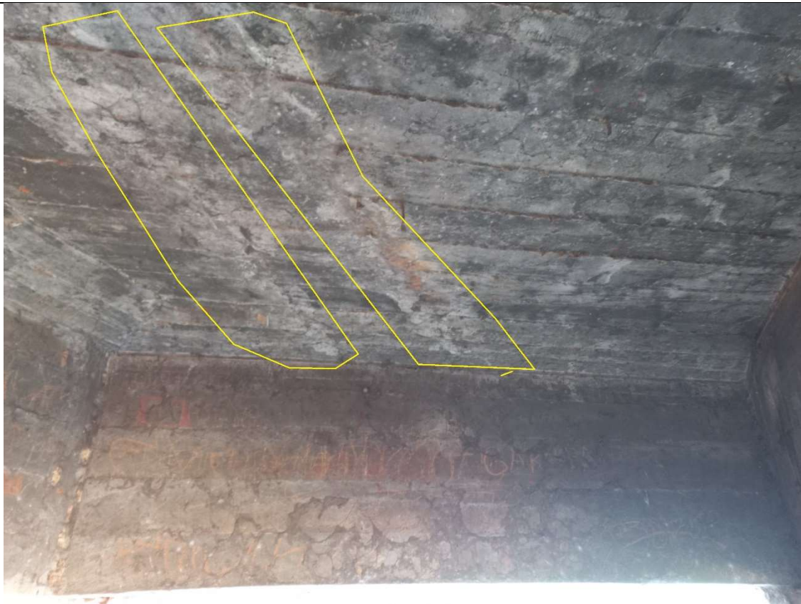
Fotografia n.º 39 – evidenciando infiltração em trincas e fissuras (26/07/2023)
