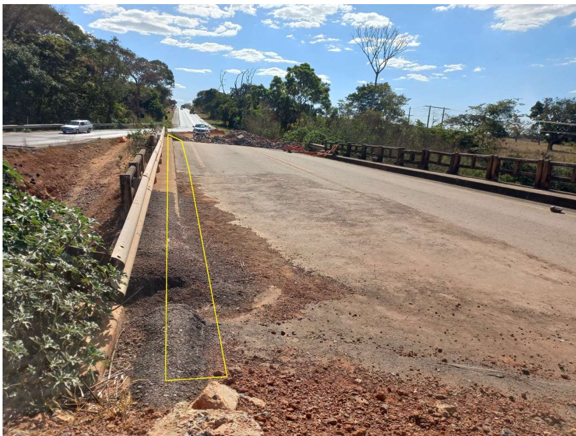
Fotografia n.º 51 – evidenciando inexistência de barreira de proteção ao pedestre (26/07/2023)
