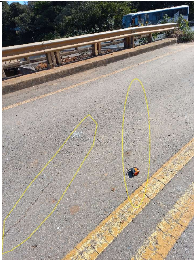
Fotografia n.º 37 – evidenciando fissuras e trincas no tabuleiro (26/07/2023)
