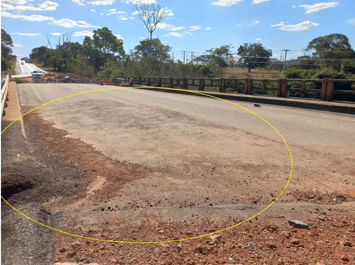
Fotografia n.º 29 – evidenciando deformação/torção do tabuleiro (26/07/2023)
