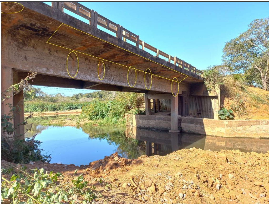
Fotografia n.º 43 – evidenciando deficiência na drenagem com a falta de buzinotes(26/07/2023)
