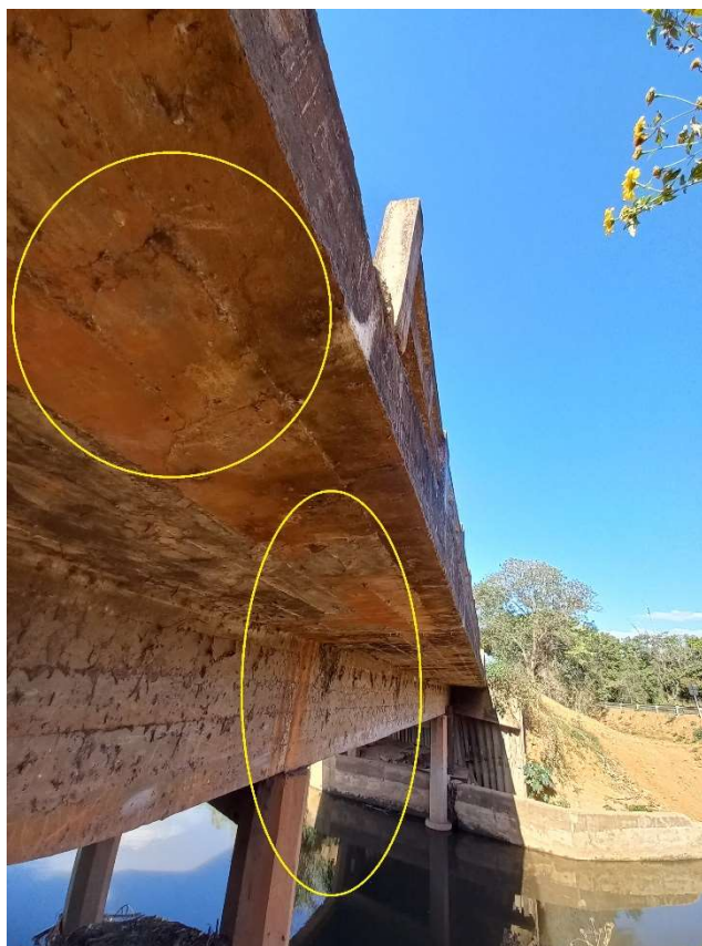
Fotografia n.º 40 – evidenciando deficiência na drenagem com a falta de buzinotes(26/07/2023)
