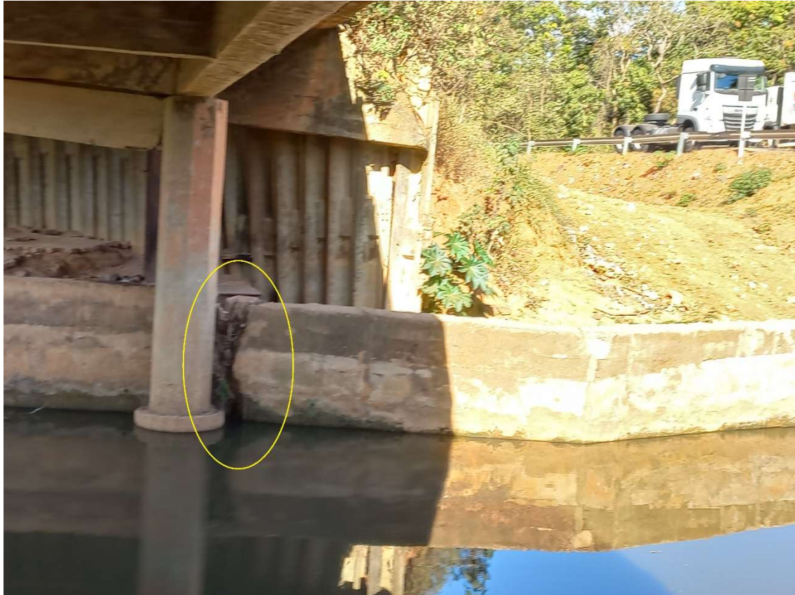
Fotografia n.º 77 – evidenciando ala rompida e rompimento do muro de concreto (26/07/2023)
