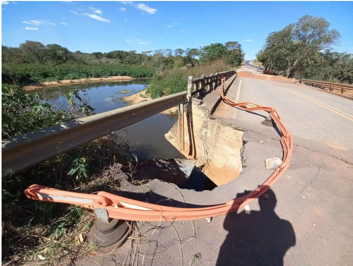
Fotografia n.º 55 – evidenciando erosão junto ao encontro/encabeçamento (26/07/2023)
