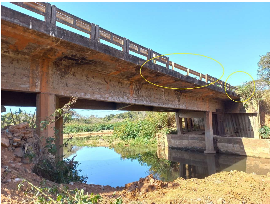
Fotografia n.º 48 – evidenciando inexistência de guarda-corpo (26/07/2023)
