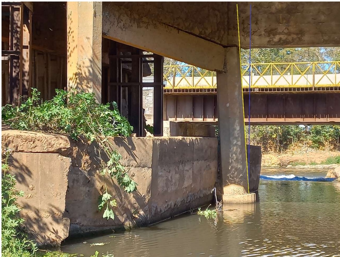
Fotografia n.º 67 – evidenciando desaparecimento do pórtico/pilar (26/07/2023)
