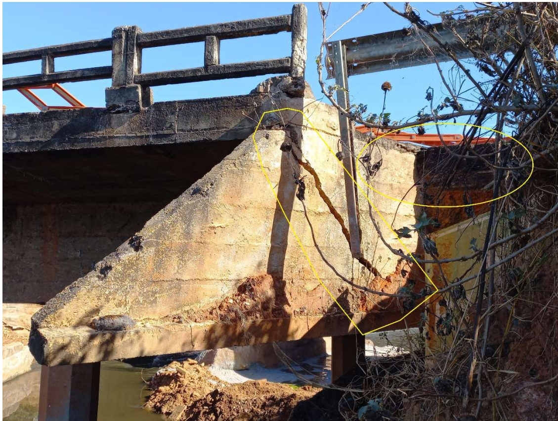
Fotografia n.º 79 – evidenciando ala rompida e erosão junto ao encontro (26/07/2023)
