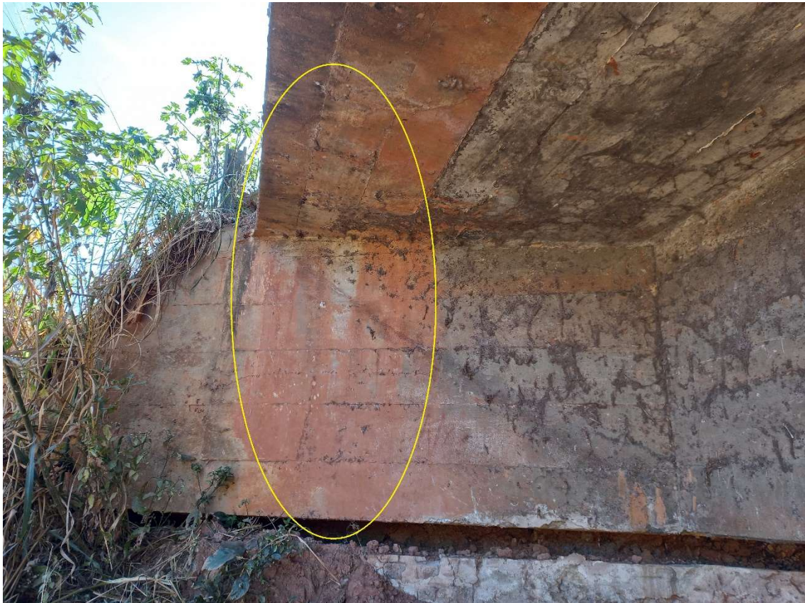
Fotografia n.º 41 – evidenciando deficiência na drenagem com a falta de buzinotes(26/07/2023)
