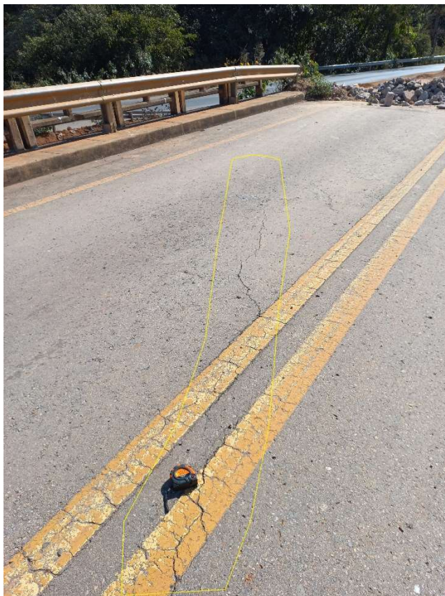
Fotografia n.º 36 – evidenciando fissuras e trincas no tabuleiro (26/07/2023)
