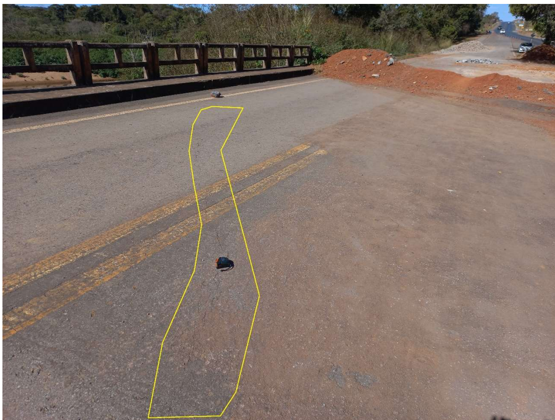
Fotografia n.º 31 – evidenciando fissuras e trincas no tabuleiro (26/07/2023)
