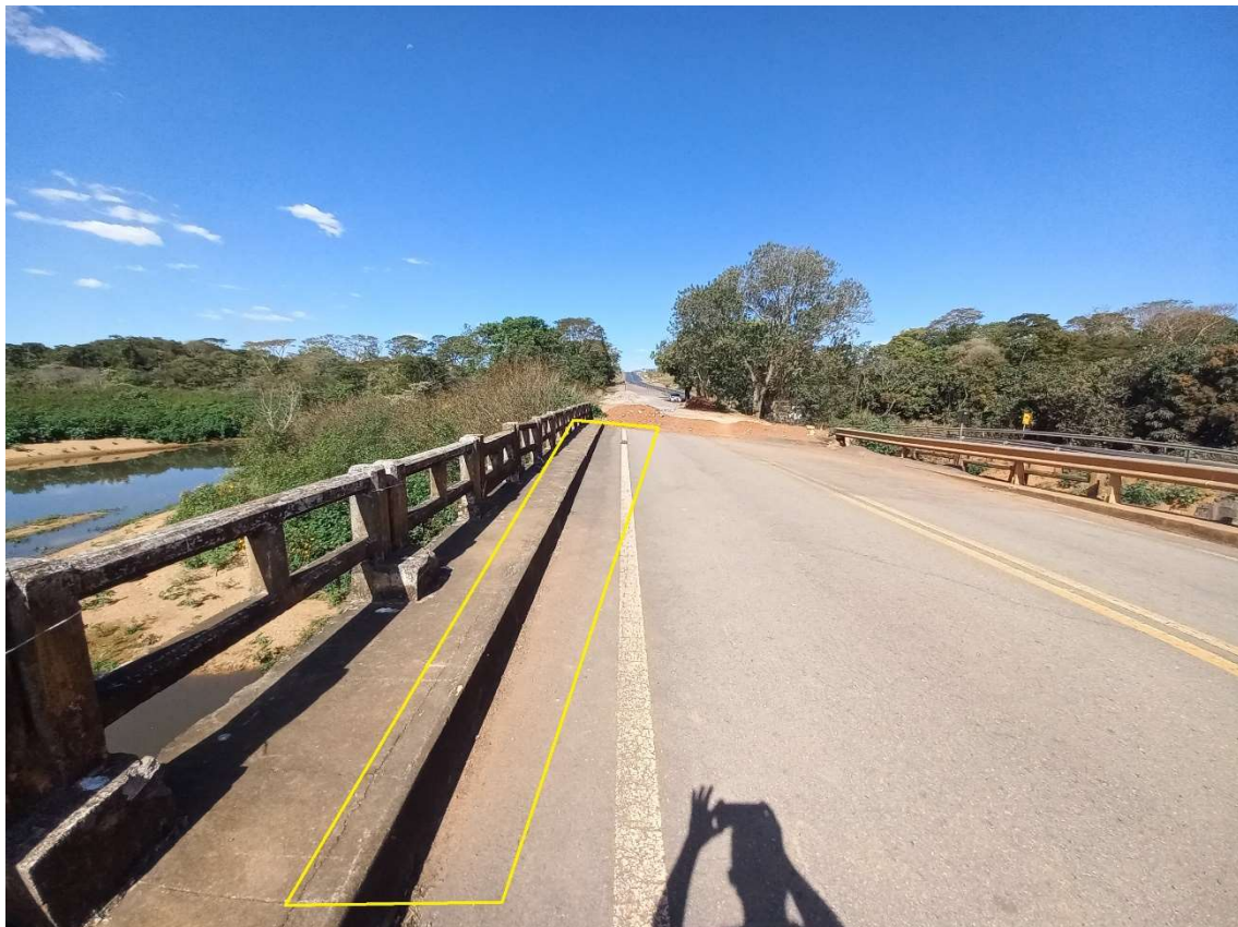
Fotografia n.º 50 – evidenciando inexistência de barreira de proteção ao pedestre (26/07/2023)
