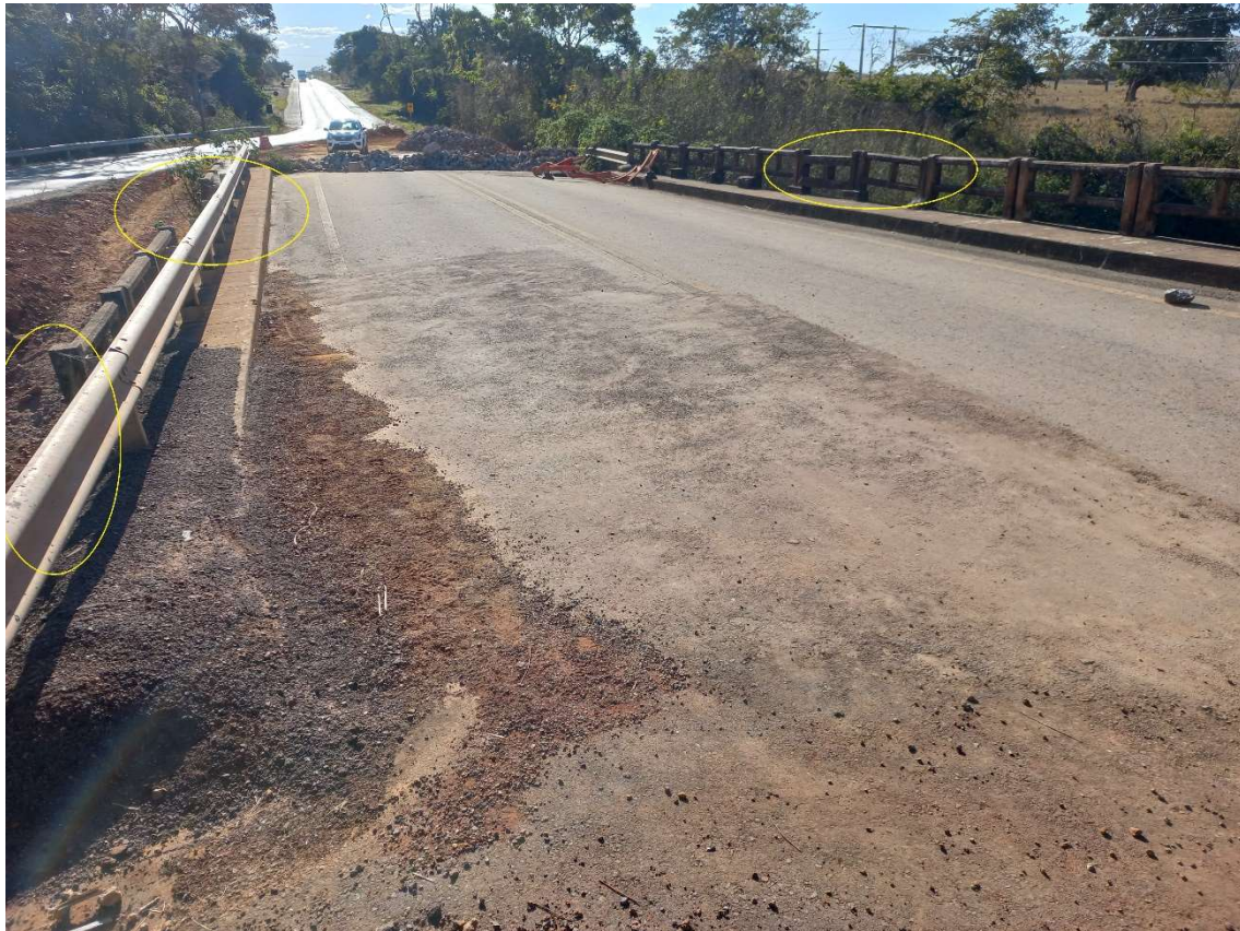
Fotografia n.º 49 – evidenciando inexistência de guarda-corpo (26/07/2023)
