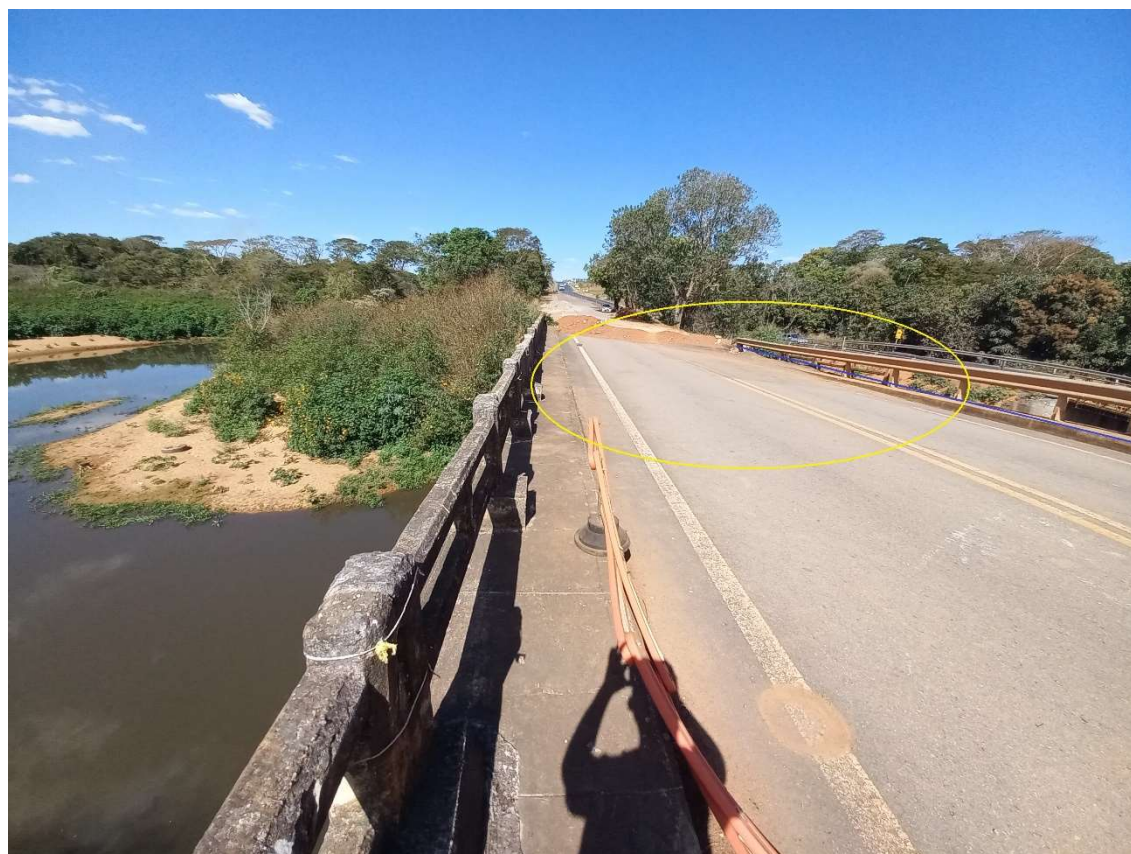
Fotografia n.º 26 – evidenciando deformação/torção do tabuleiro (26/07/2023)
