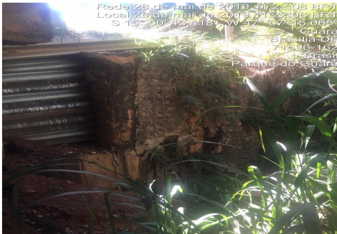
FOTO 8 -Talude de aterro com o revestimento de concreto desagregado.
