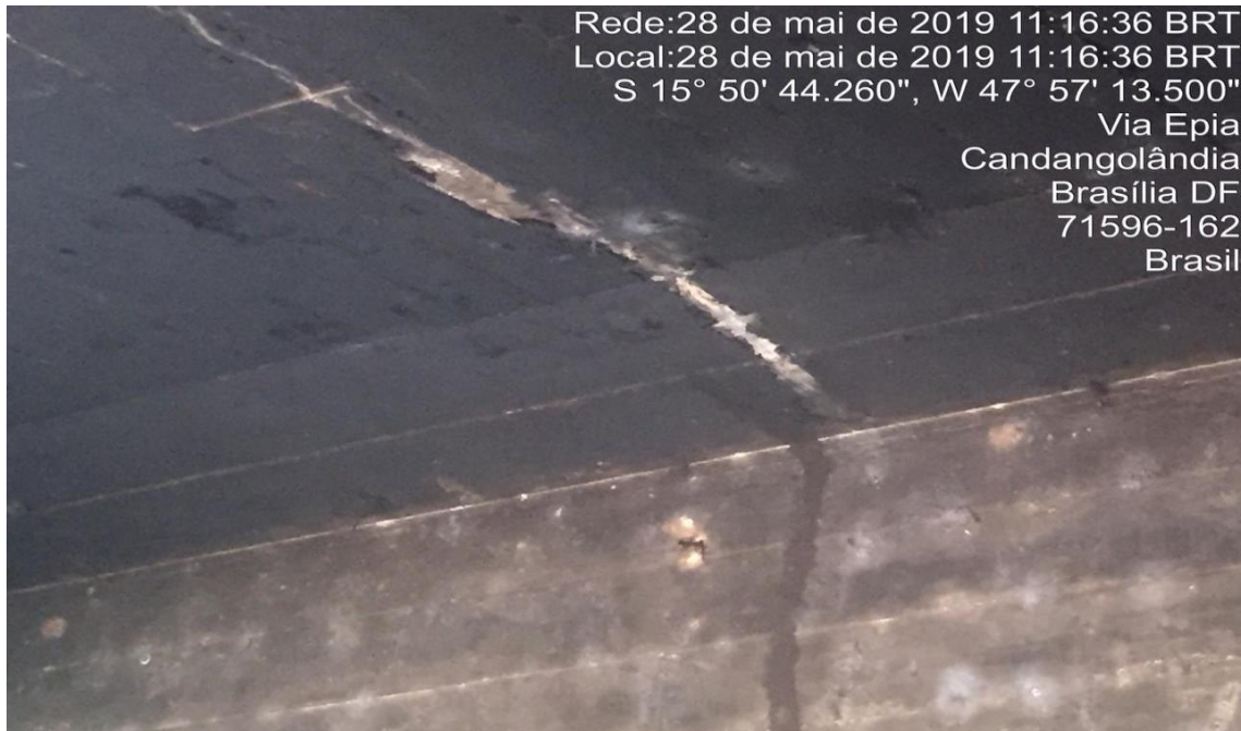
FOTO 1- Manchas de eflorações sobre a laje
