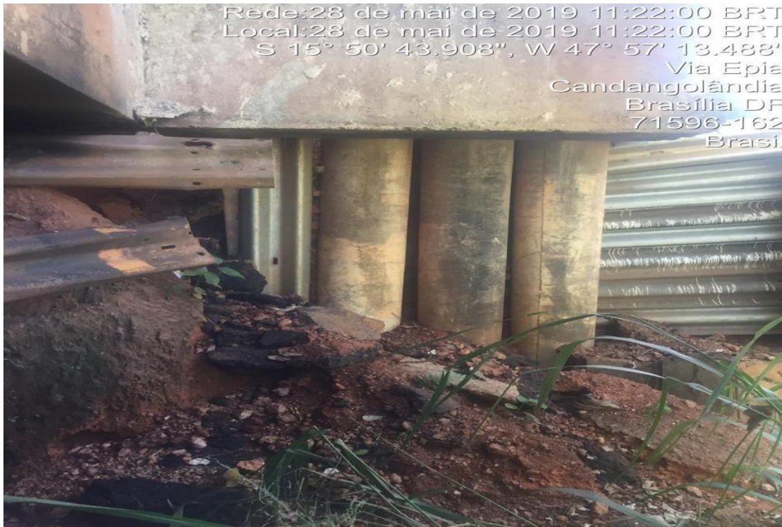
FOTO 7 -Erosão do solo sobre a cortina do encontro.
