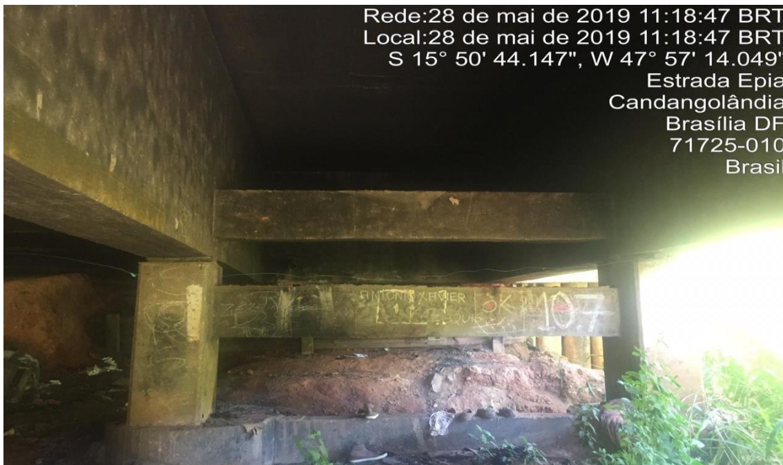
FOTO 10 -Acúmulo de sujeiras e detritos na cortina da ponte, causados por morador de rua.
