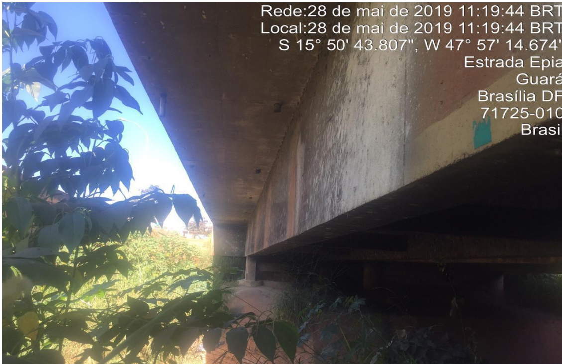
FOTO 3 - Manchas de umidade sobre a longarina devido aos buzínates entupidos
