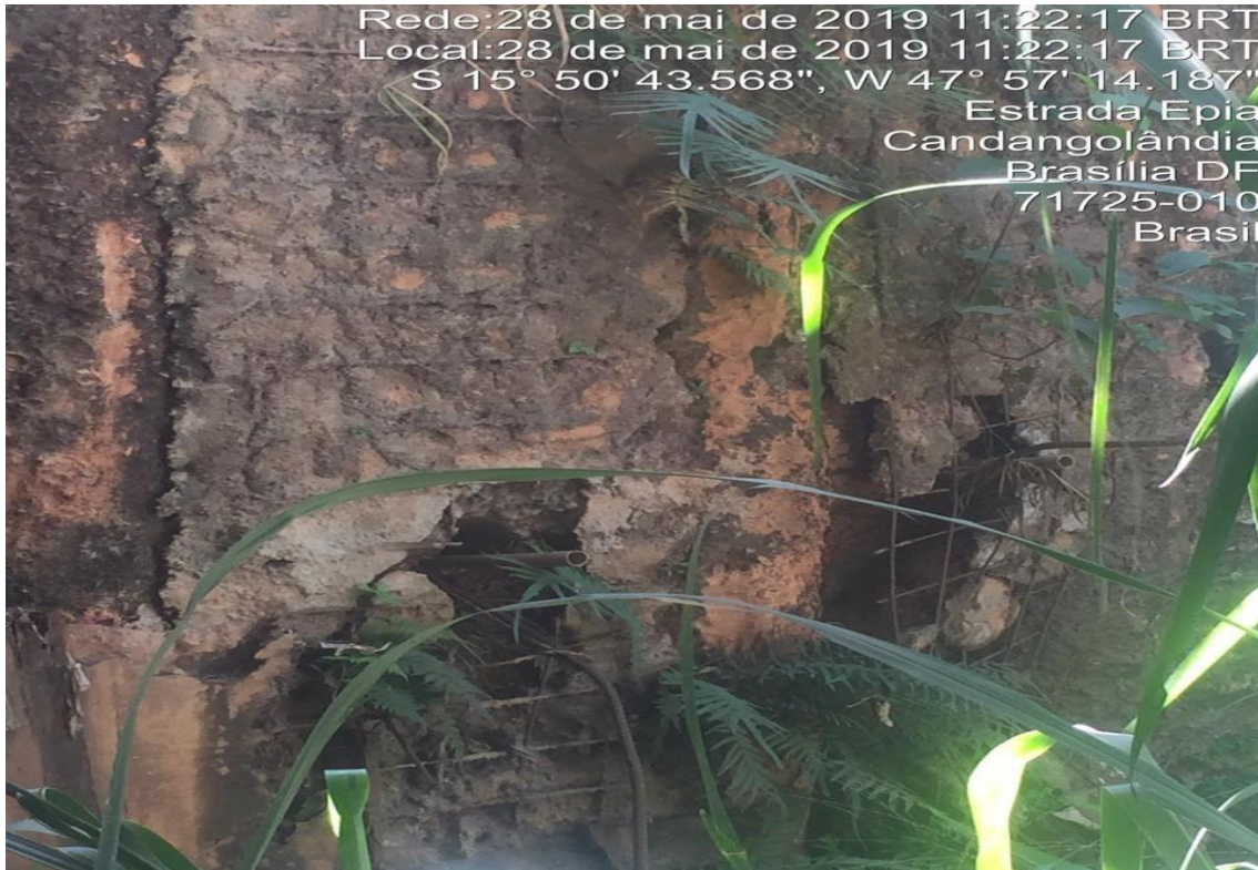
FOTO 9 - Revestimento do talude de aterro com as armaduras expostas e corroídas.
