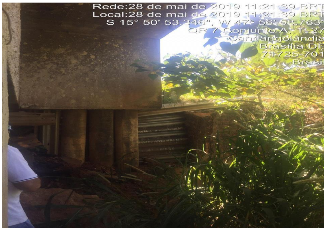
FOTO 6 -Deslocamento horizontal do talude de aterro sobre acortina/cabeceira da ponte.
