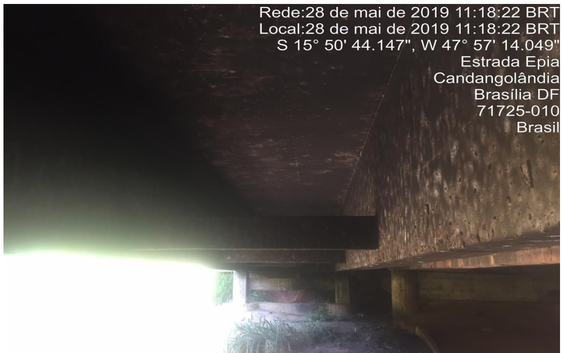
FOTO 2 -Manchas de eflorações sobre a laje e longarina
