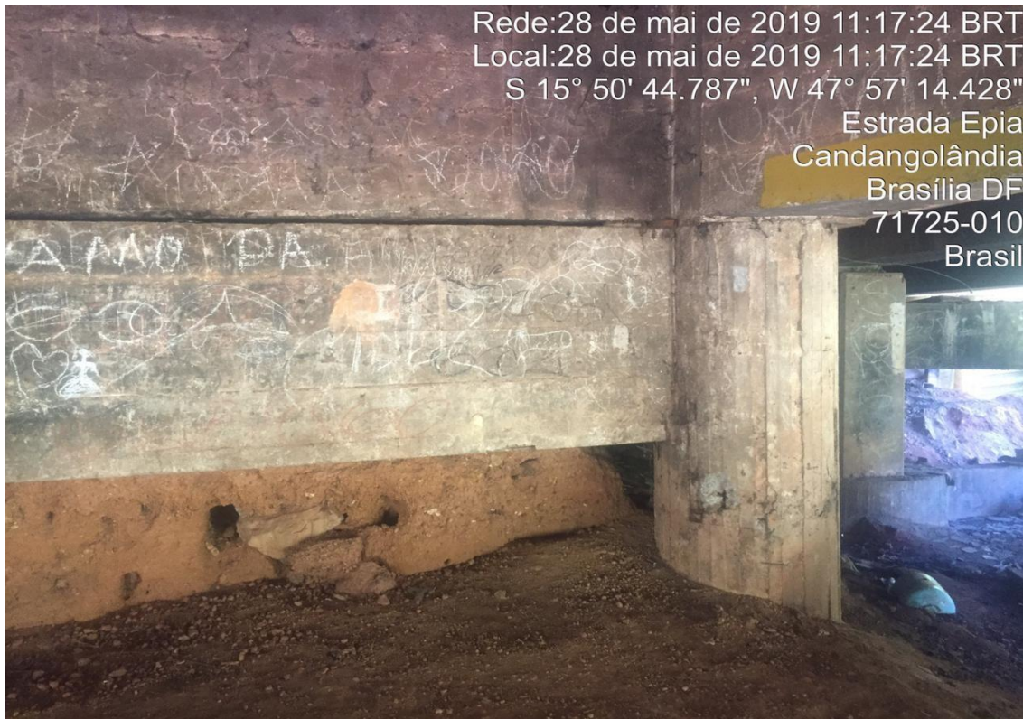
FOTO 5 -Pilar com deslocamento do concreto e armaduras corroidas
