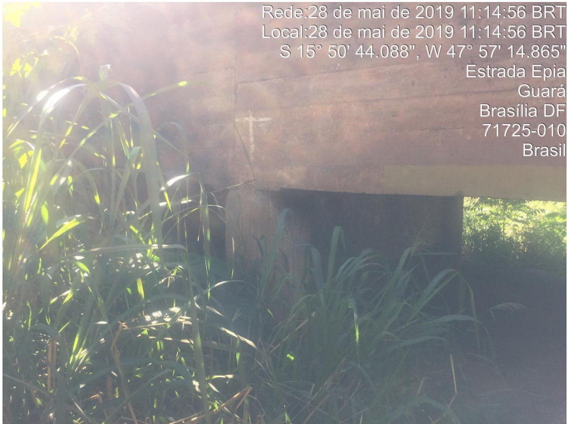
FOTO 11 -Vegetação alta dificultando o acesso a cortina da ponte.
