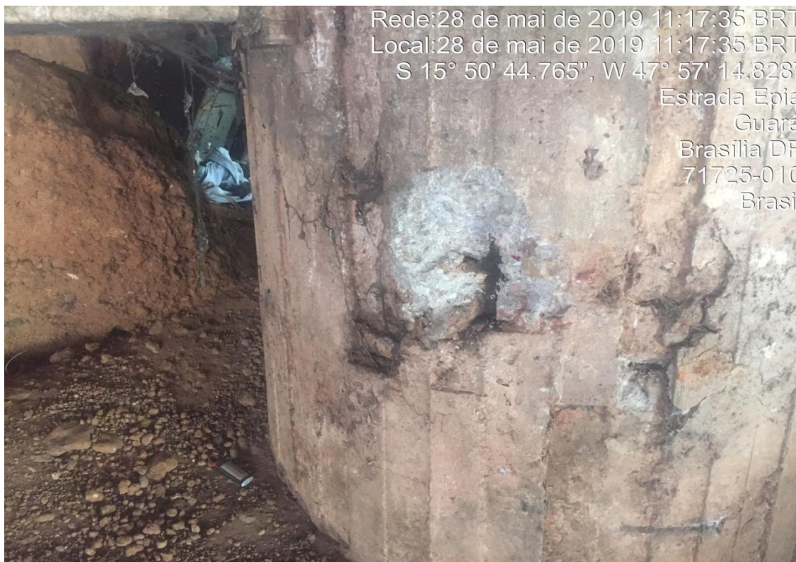
FOTO 4 - Pilar com deslocamento do concreto e armaduras corroidas
