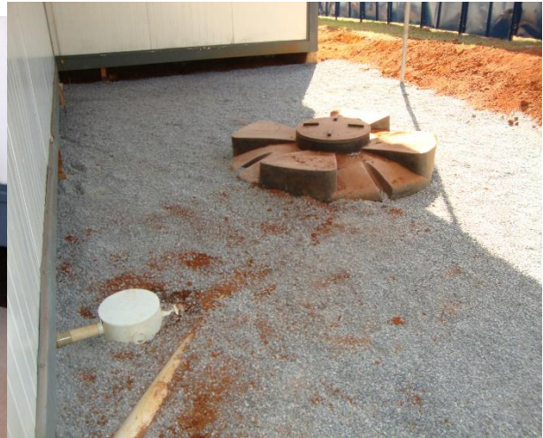
Figura 23. Fossas sépticas implantadas para o esgotamento sanitário do canteiro de obras.
