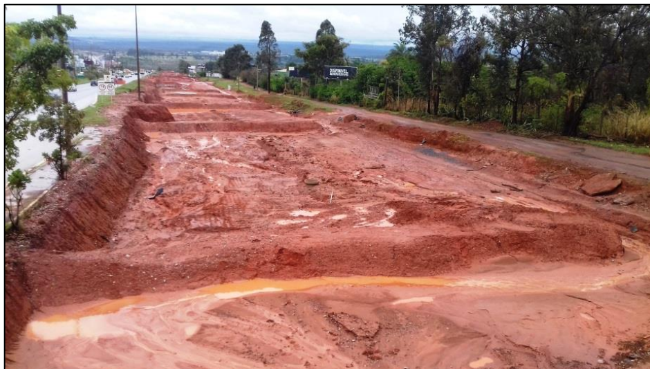
Figura 2. Processos erosivos que existiam em 2016.
